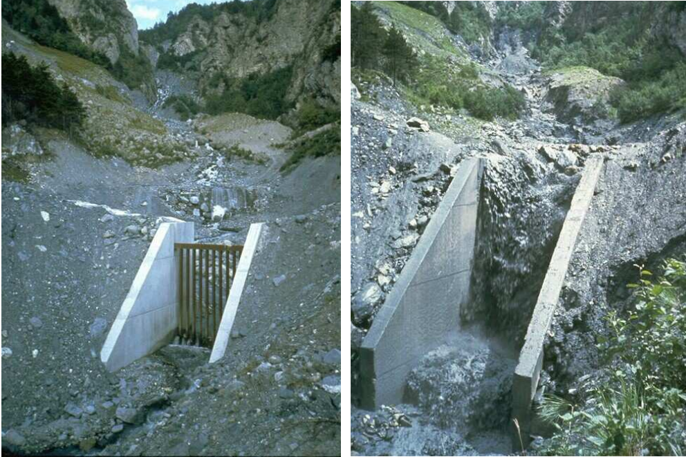
Fig. 3.3 - Exemple d'ouvrage de fermeture de plage de dépôt. A gauche en période normale, à droite lors d'une crue torrentielle. Photo M. Meunier, Cemagref.
